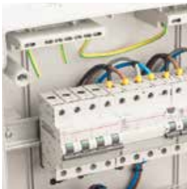
Possibilidade de instalação de terminais neutro e terra.
